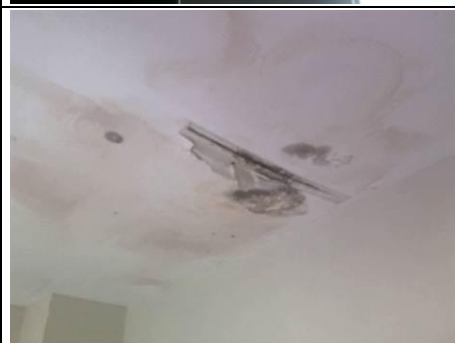
Photo n° PhTer0003 Localisation : 1er étage - Bureau 2 Parasite : Moisissures, Humidité, Dégât des eaux, Infiltration Indices : dégradation (présence)
