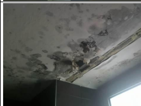
Photo n° PhTer0002 Localisation : RdC - Salle d'eau Ouvrage : Plafond - Plâtre ou assimilé et Peinture Parasite : Champignon de pourriture fibreuse, Moisissures, Humidité, Dégât des eaux, Infiltration Indices : dégradation (présence)
