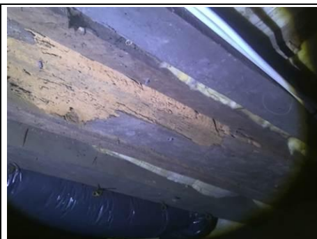
Photo n° PhTer0001 Localisation : Sous-Sol - Cave 1 Ouvrage : Solives, Plancher haut, Poutres Parasite : Petites vrillettes (Anobium punctatum), Grosses vrillettes (Xestobium rufovillosum) Indices : dégradation du bois (présence, traces)
