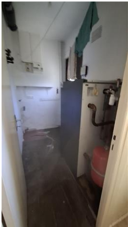
CHAUFFAGE ET PRODUCTION D ECS
