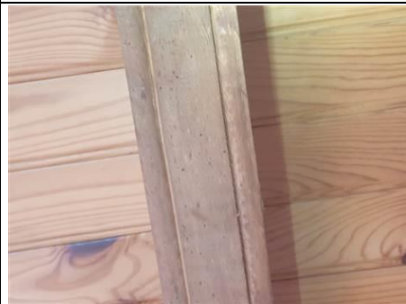
Photo n° PhTer005 Localisation : 1er étage - Chambre 1 Ouvrage : ----- MAISON -----, Boiseries Parasite : ---- Insectes à larves xylophages ----, Anobium punctatum (Petites vrillettes) Indices : présence de trous de sortie (présence faible) (pas de vermoulure)
