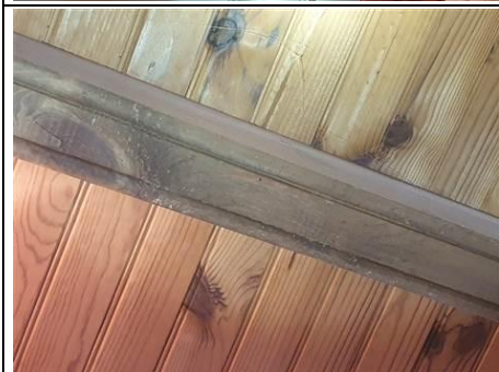
Photo n° PhTer006 Localisation : 1er étage - Pièce 1 Ouvrage : ----- MAISON -----, Boiseries Parasite : ---- Insectes à larves xylophages ----, Anobium punctatum (Petites vrillettes) Indices : présence de trous de sortie (présence faible) (pas de vermoulure)
