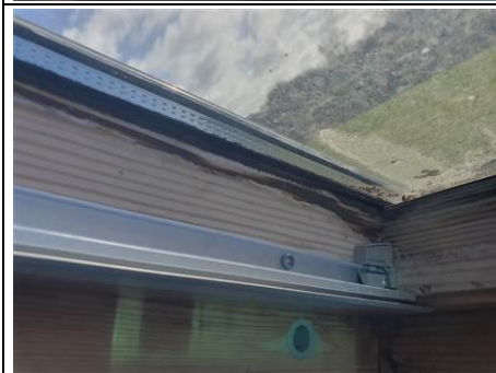
Photo n° PhTer009 Localisation : Combles - Chambre 3 Ouvrage : ----- MAISON -----, Boiseries, Fenêtre Parasite : Moisissures Indices : présence de spore (présence faible)
