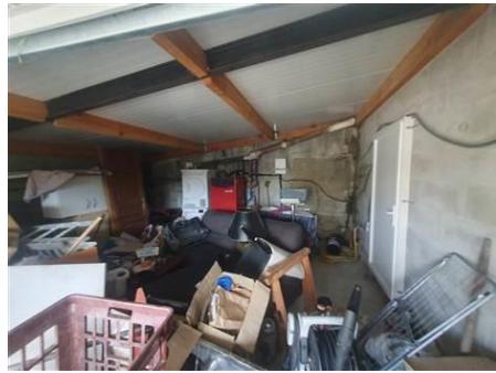
Photo n° PhTer011 Localisation : Garage Ouvrage : ----- MAISON -----, Murs Parasite : Moisissures salpêtre Indices : présence de spore (présence étendue)
