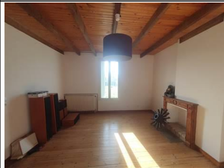
Photo n° PhTer005 Localisation : 1er étage - Chambre 1 Ouvrage : ----- MAISON -----, Boiseries Parasite : ---- Insectes à larves xylophages ----, Anobium punctatum (Petites vrillettes) Indices : présence de trous de sortie (présence faible) (pas de vermoulure)
