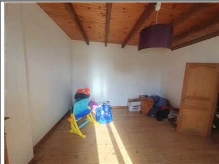
Photo n° PhTer005 Localisation : 1er étage - Chambre 1 Ouvrage : ----- MAISON -----, Boiseries Parasite : ---- Insectes à larves xylophages ----, Anobium punctatum (Petites vrillettes) Indices : présence de trous de sortie (présence faible) (pas de vermoulure)
