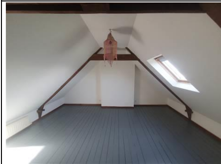
Photo n° PhTer010 Localisation : Combles - Chambre 4 Ouvrage : ----- MAISON -----, Boiseries, Fenêtre Parasite : ---- Insectes à larves xylophages ----, Anobium punctatum (Petites vrillettes), Moisissures Indices : présence de trous de sortie (présence faible) (pas de vermoulure), présence de spore (présence faible)
