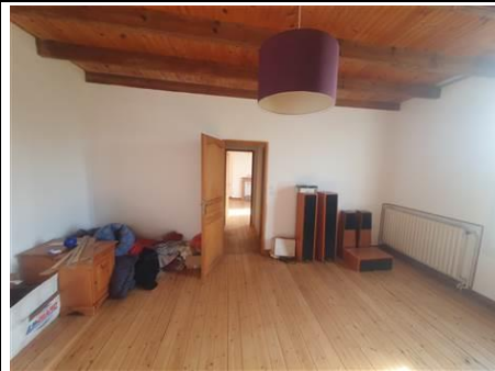
Photo n° PhTer005 Localisation : 1er étage - Chambre 1 Ouvrage : ----- MAISON -----, Boiseries Parasite : ---- Insectes à larves xylophages ----, Anobium punctatum (Petites vrillettes) Indices : présence de trous de sortie (présence faible) (pas de vermoulure)
