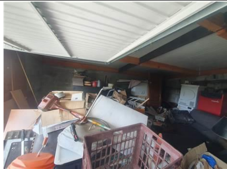
Photo n° PhTer011 Localisation : Garage Ouvrage : ----- MAISON -----, Murs Parasite : Moisissures salpêtre Indices : présence de spore (présence étendue)
