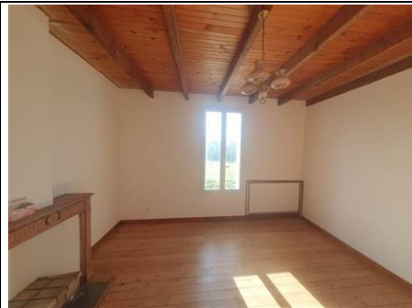
Photo n° PhTer007 Localisation : 1er étage - Chambre 2 Ouvrage : ----- MAISON -----, Boiseries Parasite : ---- Insectes à larves xylophages ----, Anobium punctatum (Petites vrillettes) Indices : présence de trous de sortie (présence faible) (pas de vermoulure)
