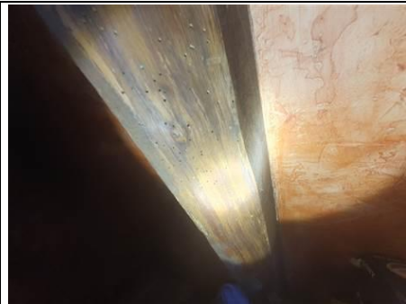
Photo n° PhTer008 Localisation : Combles - Palier 2 Ouvrage : ----- MAISON -----, Boiseries, Fenêtre Parasite : ---- Insectes à larves xylophages ----, Anobium punctatum (Petites vrillettes), Moisissures Indices : présence de trous de sortie (présence faible) (pas de vermoulure), présence de spore (présence faible)
