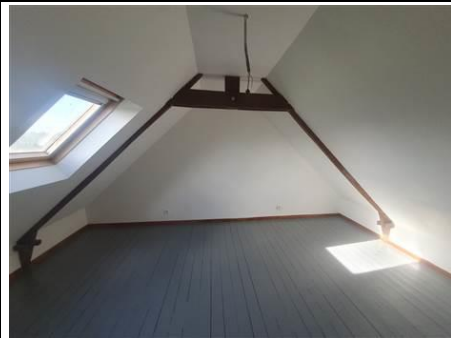
Photo n° PhTer009 Localisation : Combles - Chambre 3 Ouvrage : ----- MAISON -----, Boiseries, Fenêtre Parasite : Moisissures Indices : présence de spore (présence faible)
