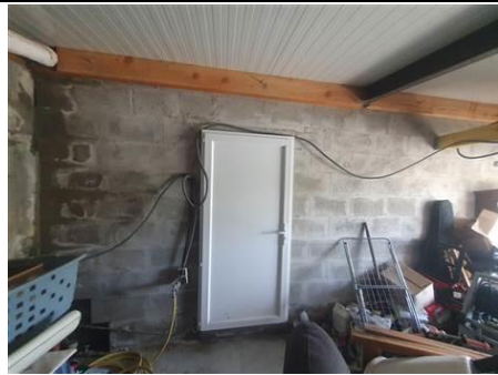
Photo n° PhTer011 Localisation : Garage Ouvrage : ----- MAISON -----, Murs Parasite : Moisissures salpêtre Indices : présence de spore (présence étendue)
