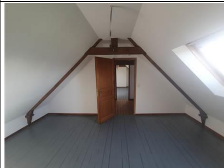
Photo n° PhTer009 Localisation : Combles - Chambre 3 Ouvrage : ----- MAISON -----, Boiseries, Fenêtre Parasite : Moisissures Indices : présence de spore (présence faible)
