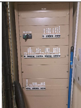
COFFRET D'UN NIVEAU
