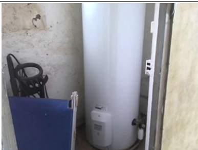
Photo PhDPE005 Ouvrage : ECSanitaires Description : Ballon électrique à accumulation vertical (catégorie C ou 3 étoiles), contenance ballon 300 L
