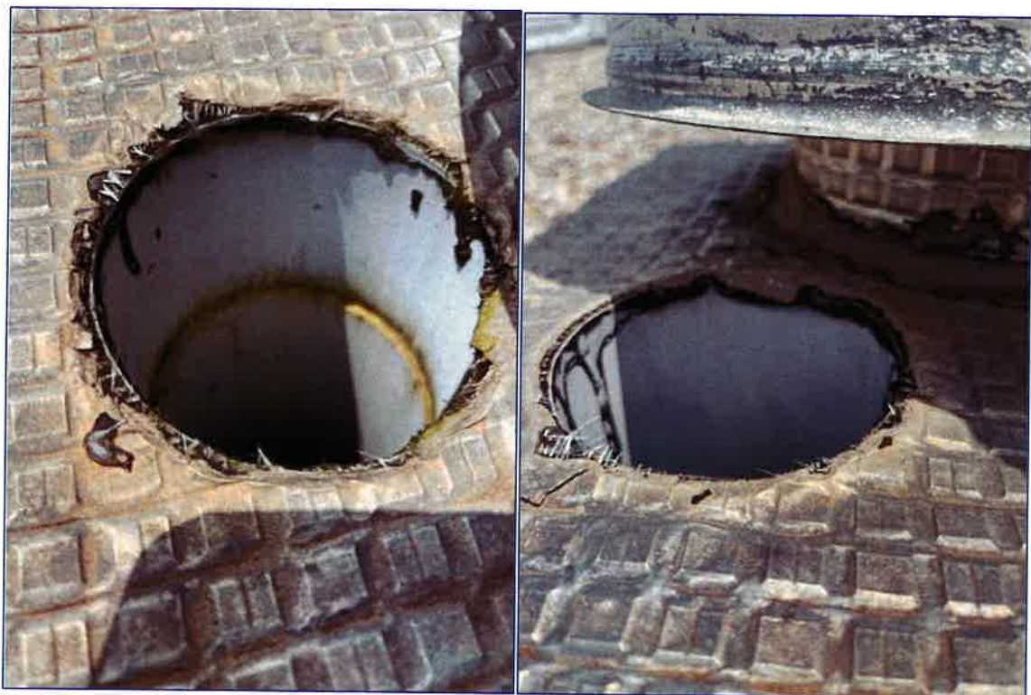
Jonctions relevés d'étanchéités/tuyau d'évent défaillant
