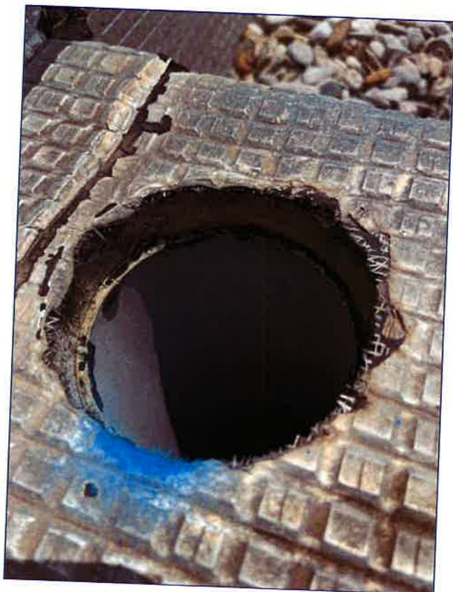
Jonction relevé d'étanchéité tuyau PVC de l'évent défaillant
