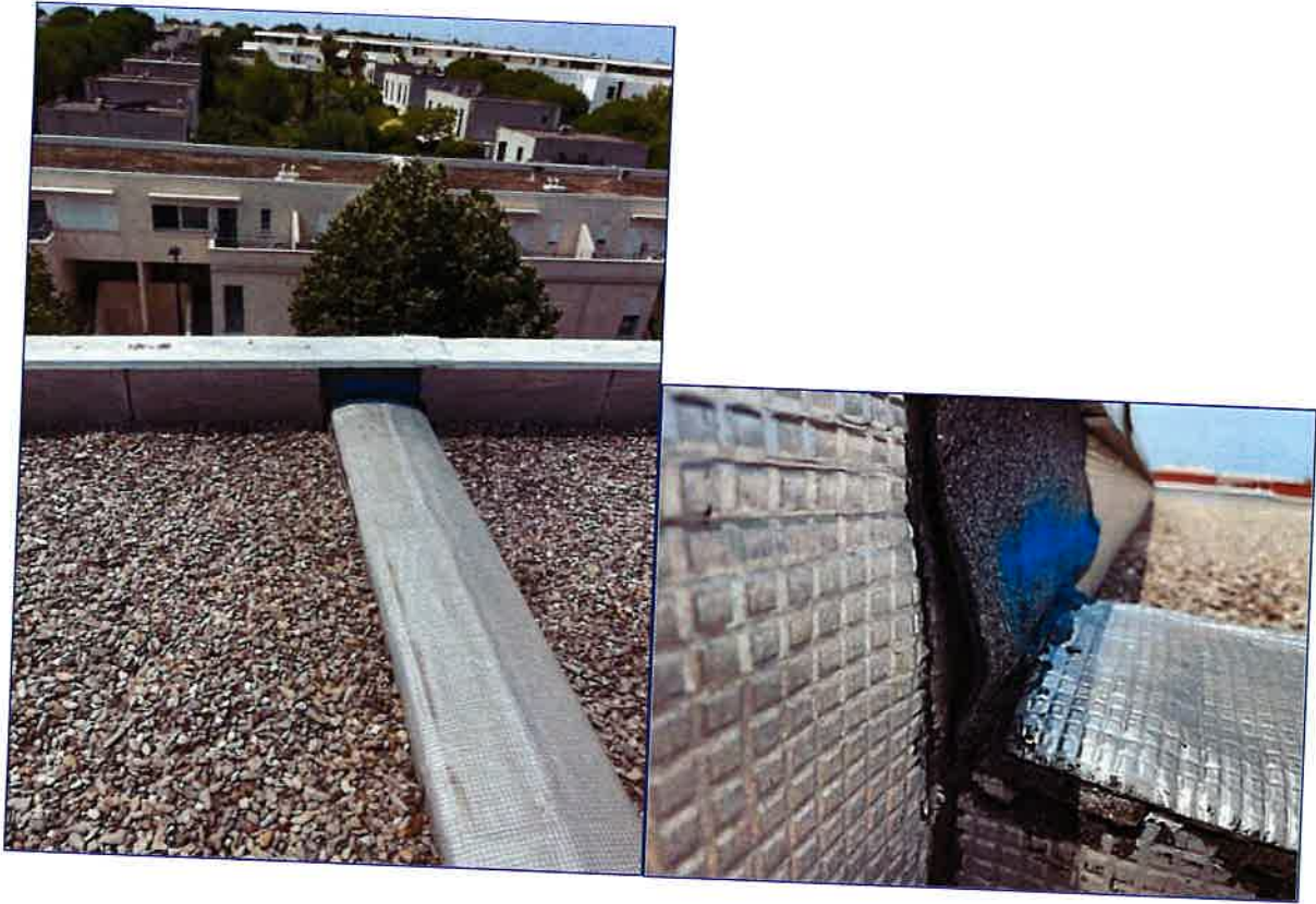
Relevés d'étanchéité au joint de dilatation défectueux
