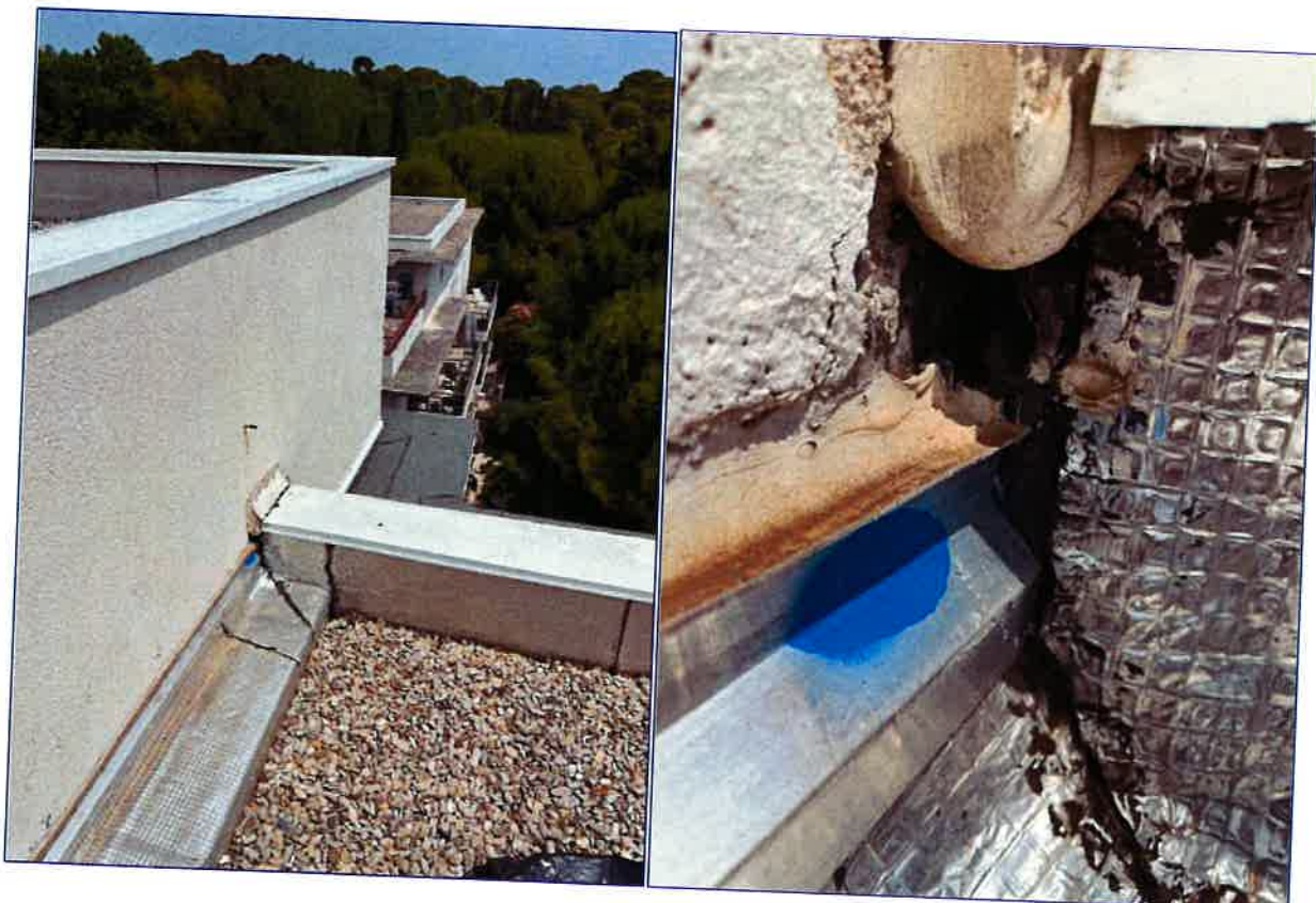
Joint de dilatation décalé non recouvert
