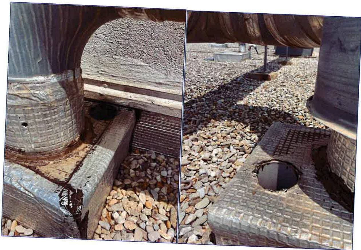
Jonctions relevés d'étanchéité tuyaux PVC des événements défectueux
