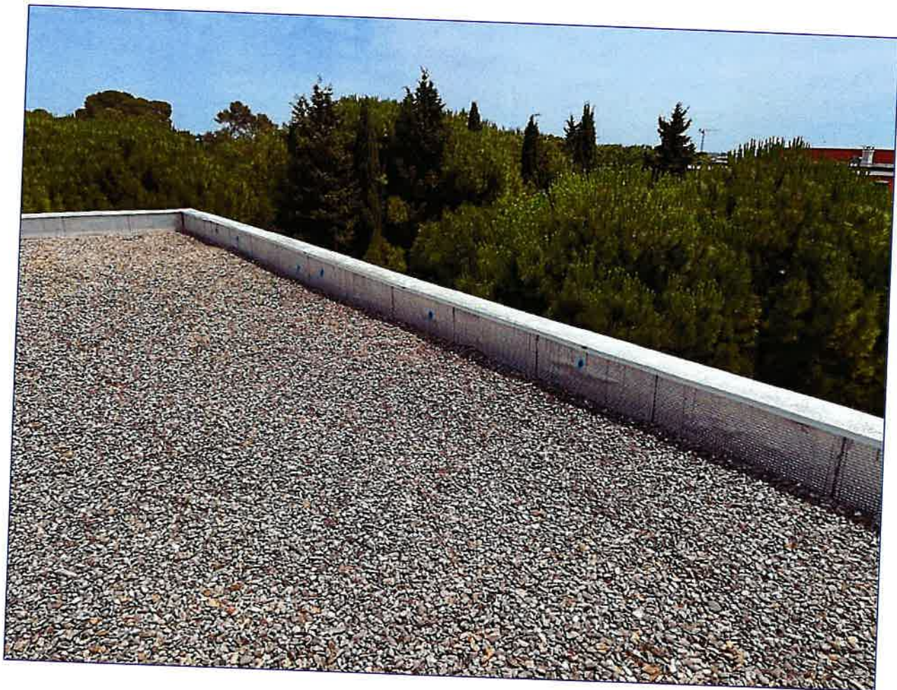
Relevés d'étanchéité défectueux
