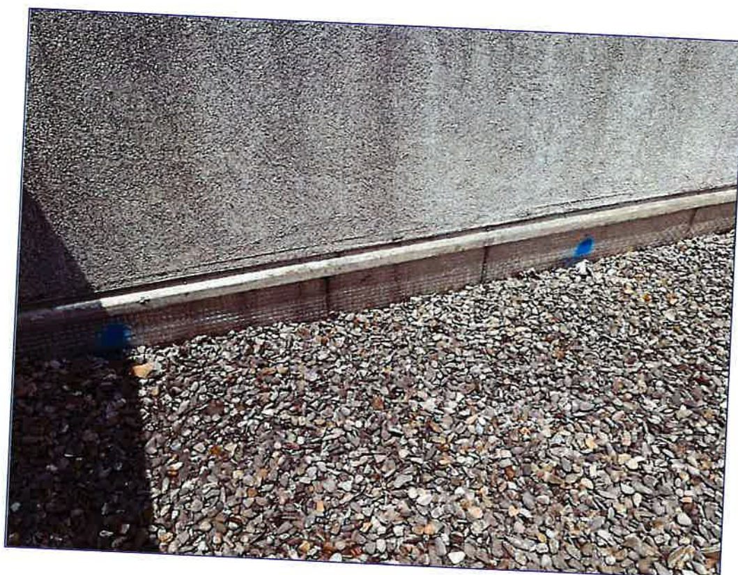
Relevés d'étanchéité défectueux
