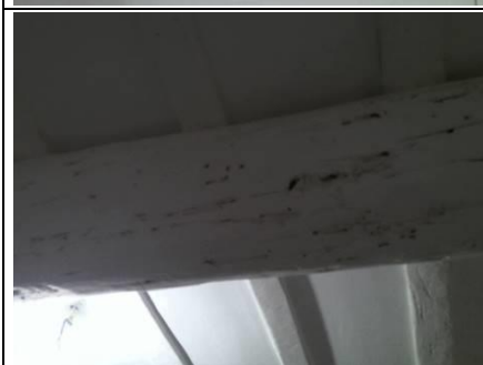
Photo n° PhTer004 Localisation : N1 - Chambre 2 Ouvrage : Poutres Parasite : Présence d'indices d'infestation d'autres agents de dégradation biologique du bois Indices : altérations dans le bois (dégradation(s) faible(s))
