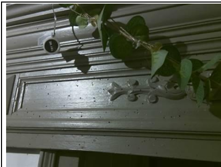
Photo n° PhTer001 Localisation : RdC - Chambre Ouvrage : Boiseries Parasite : Présence d'indices d'infestation d'autres agents de dégradation biologique du bois Indices : altérations dans le bois (dégradation(s) faible(s))
