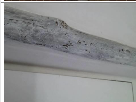
Photo n° PhTer003 Localisation : N1 - Dégagement Ouvrage : Boiseries, porte Parasite : Présence d'indices d'infestation d'autres agents de dégradation biologique du bois Indices : altérations dans le bois (dégradation(s) faible(s))
