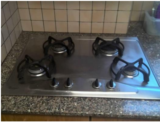
Photo n° PhGaz001 Localisation : Rez de chaussée - Buanderie Table de cuisson WHIRLPOOL (Type : Non raccordé)
