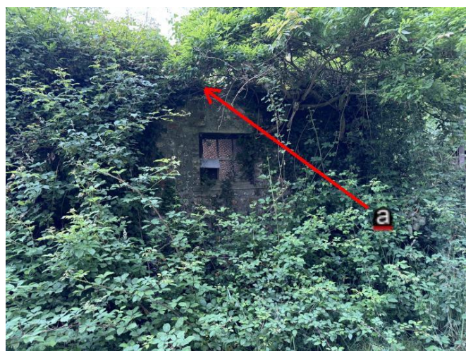
Tôle ondulée fibrociment (AMIANTE) -> Batiment non visitable
