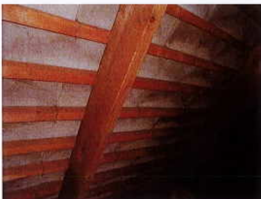
Visuel des Tuiles ardoises, FIBRES Ciment en Toiture de la Maison, en Combles perdus au 3 e étage
