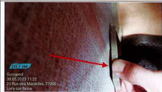
Photo Ph003 Libellé de l'anomalie : B7.3 a L'Enveloppe d'au moins un matériel est manquante ou détériorée. Remarques : Présence de matériel électrique en place dont l'enveloppe présente des détériorations ; Faire intervenir un électricien qualifié afin de remplacer les matériels présentant des détériorations
