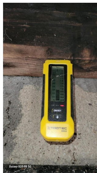
Garage 02 (Charpente) : Taux d'humidité 22%. Risque de développement de champignons lignivores.
