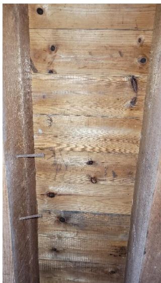
Garage 01 (Plancher haut) : Présence de traces de petites vrillettes avec altération biologique Vermoulures, Trous de sortie circulaires.
