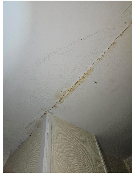
Degagement 01 : Présence de traces d'humidité
