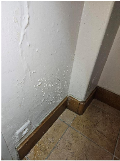
Entrée : Cloquage des murs. Présence de salpêtre signe d'une humidité importante
