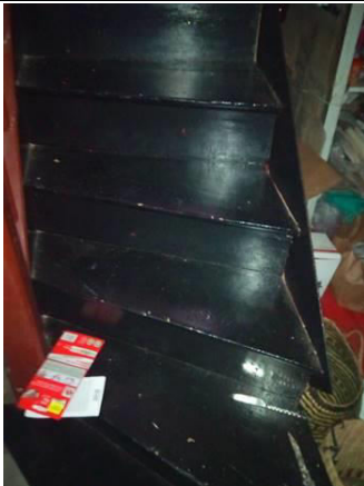
Photo n° PhTer002 Localisation : Sous-Sol - Cave Ouvrage : Escalier bois Parasite : Anobium punctatum (Petites vrillettes) Indices : présence de trous de sortie
