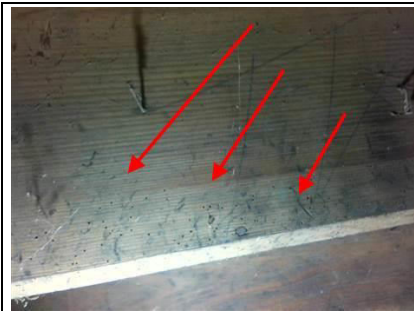
Photo n° PhTer002 Localisation : Sous-Sol - Cave Ouvrage : Escalier bois Parasite : Anobium punctatum (Petites vrillettes) Indices : présence de trous de sortie
