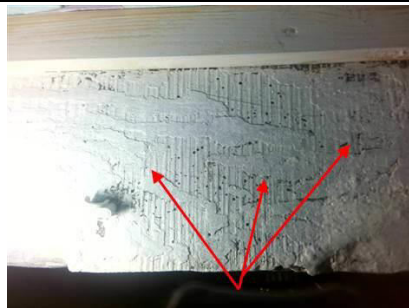
Photo n° PhTer001 Localisation : Sous-Sol - Cave Ouvrage : Plafond - Bois et styrodur Parasite : Anobium punctatum (Petites vrillettes) Indices : présence de trous de sortie Informations complémentaires : plancher haut non visible recouvert styrodur
