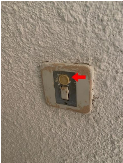
B.8.3 a) : L'installation comporte au moins un matériel électrique vétuste.
