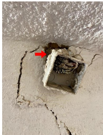
B.7.3 a) : L'enveloppe d'au moins un matériel est manquante ou détériorée.
