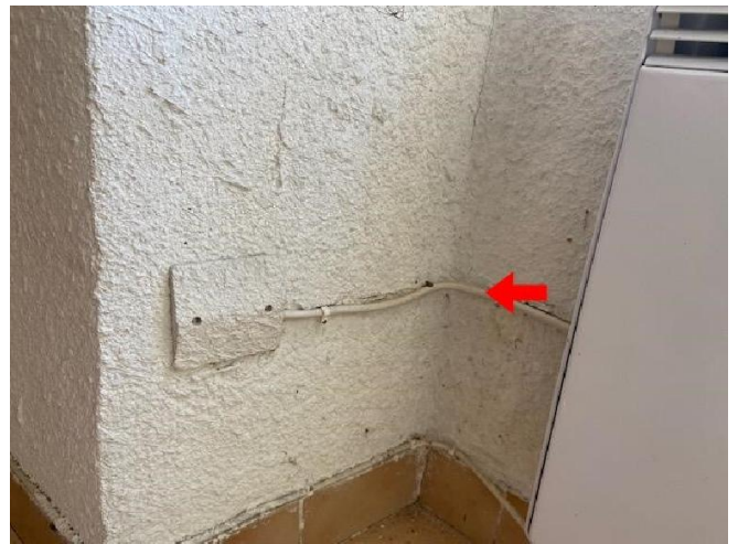
B.8.3 e) : Au moins un conducteur isolé n'est pas placé sur toute sa longueur dans un conduit, une goulotte, une plinthe ou une huisserie, en matière isolante ou métallique, jusqu'à sa pénétration dans le matériel électrique qu'il alimente.
