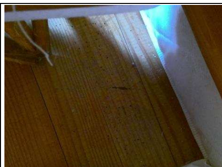
Photo n° PhTer023 Localisation : Etage 1 - Rangement Ouvrage : Sol - plancher inconnue et Parquet Parasite : Insectes à larves xylophages Indices : orifices obturés ou non (présence sur tout l'élément concerné) Localisation sur croquis : 023
