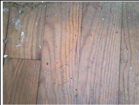
Photo n° PhTer017 Localisation : Etage 1 - Chambre 2 Ouvrage : Sol - plancher inconnue et Parquet Parasite : Insectes à larves xylophages Indices : orifices obturés ou non (présence sur tout l'élément concerné) Localisation sur croquis : 017
