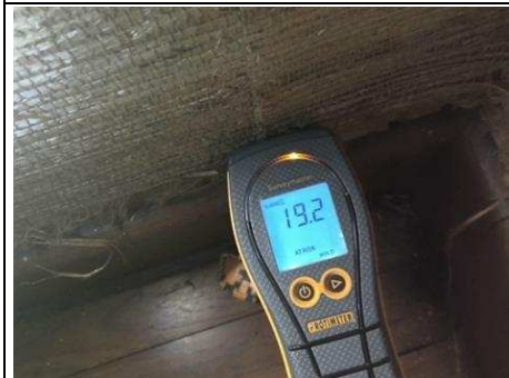
Photo n° PhTer010 Localisation : Rez de Chaussée - Séjour Ouvrage : Mur - plâtre et Tapisserie Informations complémentaires : Hygrométrie de surface égale à 19,2 % Localisation sur croquis : 010
