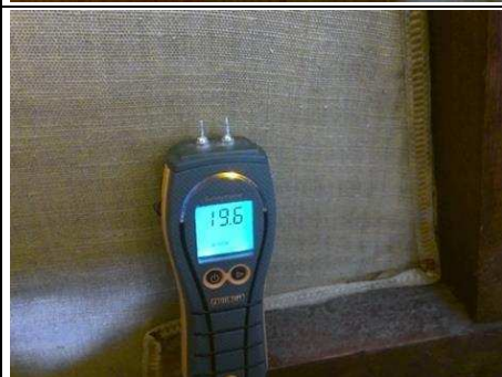
Photo n° PhTer024 Localisation : Etage 1 - Chambre 5 Ouvrage : Mur - plâtre et tissu mural et pièce de charpente bois Informations complémentaires : Hygromètre de surface égale à 19,6%, Présence de moisissures sur les murs Localisation sur croquis : 024
