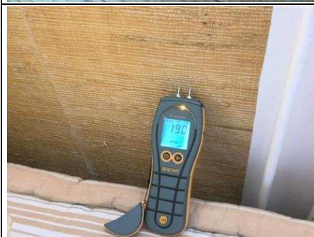
Photo n° PhTer021 Localisation : Etage 1 - Chambre 4 Ouvrage : Mur - plâtre et Tapisserie Informations complémentaires : Hygrométrie de surface égale à 19 % Localisation sur croquis : 021
