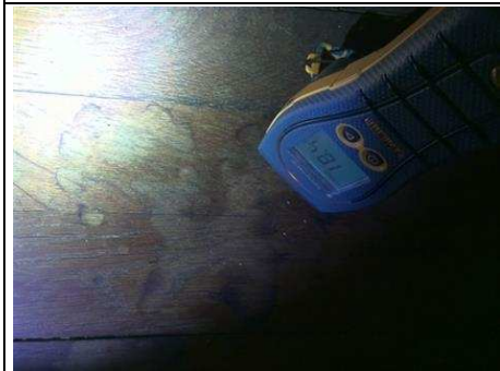
Photo n° PhTer009 Localisation : Rez de Chaussée - Séjour Ouvrage : Sol - béton et Parquet Informations complémentaires : Hygrométrie de surface égale à 18,4 %, Présence de traces d'infiltration Localisation sur croquis : 009
