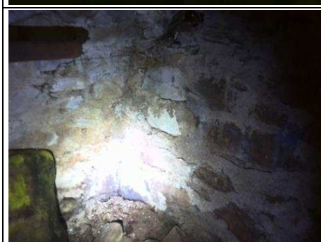
Photo n° PhTer003 Localisation : Sous-Sol - Cave 2 Ouvrage : Mur - pierres Informations complémentaires : Présence de salpêtre, Présence d'une forte humidité (point valable pour le plafond également) Localisation sur croquis : 003
