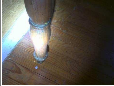
Photo n° PhTer015 Localisation : Rez de Chaussée - Bureau Ouvrage : Sol - béton et Parquet Parasite : Insectes à larves xylophages Indices : orifices obturés ou non (présence sur tout l'élément concerné) Localisation sur croquis : 015
