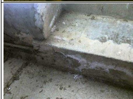
Photo n° PhTer001 Localisation : Sous-Sol - Cave 1 Ouvrage : Mur - pierres Informations complémentaires : Hygrométrie de surface mesurée supérieure à 25%, Présence de remontées capillaires, Présence de salpêtre Localisation sur croquis : 001
