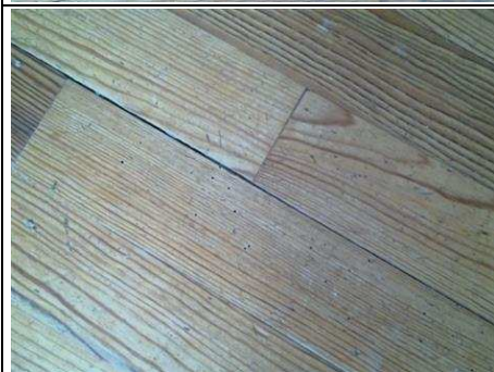
Photo n° PhTer020 Localisation : Etage 1 - Chambre 4 Ouvrage : Sol - plancher inconnue et Parquet Parasite : Insectes à larves xylophages Indices : orifices obturés ou non (présence sur tout l'élément concerné) Localisation sur croquis : 020
