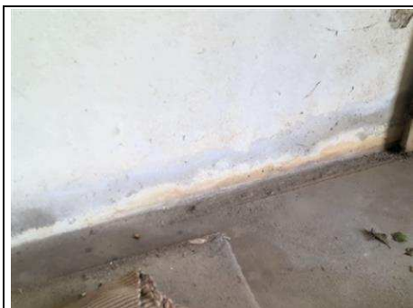
Photo n° PhTer008 Localisation : Rez de jardin - Garage Ouvrage : Mur - maçonnerie Informations complémentaires : Hygrométrie de surface mesurée supérieure à 25%, Présence de remontées capillaires Localisation sur croquis : 008
