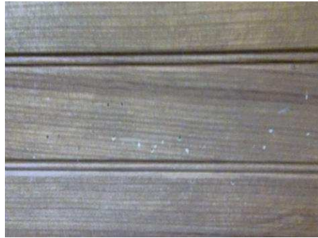
Photo n° PhTer007 Localisation : Rez de jardin - Garage Ouvrage : Plafond - Lambris bois et Vernis Parasite : Insectes à larves xylophages Indices : orifices obturés ou non (présence sur tout l'élément concerné) Localisation sur croquis : 007
