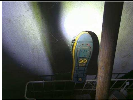
Photo n° PhTer008 Localisation : Rez de jardin - Garage Ouvrage : Mur - maçonnerie Informations complémentaires : Hygrométrie de surface mesurée supérieure à 25%, Présence de remontées capillaires Localisation sur croquis : 008
