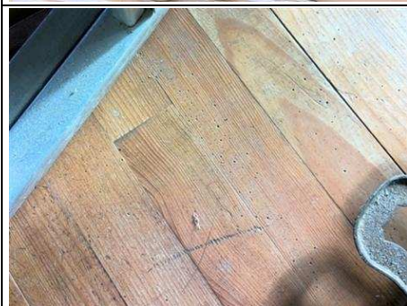
Photo n° PhTer022 Localisation : Etage 1 - Palier Ouvrage : Sol - plancher inconnu et Parquet Parasite : Insectes à larves xylophages Indices : orifices obturés ou non (présence sur tout l'élément concerné) Localisation sur croquis : 022
