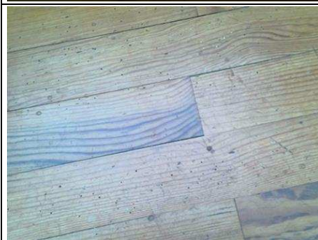
Photo n° PhTer019 Localisation : Etage 1 - Chambre 3 Ouvrage : Sol - plancher inconnue et Parquet Parasite : Insectes à larves xylophages Indices : orifices obturés ou non (présence sur tout l'élément concerné) Localisation sur croquis : 019
