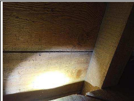
Photo n° PhTer027 Localisation : Etage 2 - Combles Ouvrage : Plafond - voliges bois et charpente bois Parasite : Insectes à larves xylophages Indices : orifices obturés ou non, présence de vermoulure (présence sur tout l'élément concerné) Localisation sur croquis : 027
