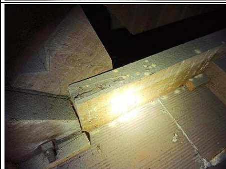
Photo n° PhTer026 Localisation : Etage 2 - Combles Ouvrage : Sol - brique plafonnière et solives bois et Parquet (sur une petite partie) Parasite : Insectes à larves xylophages Indices : orifices obturés ou non, présence de vermoulure (présence sur tout l'élément concerné) Localisation sur croquis : 026
