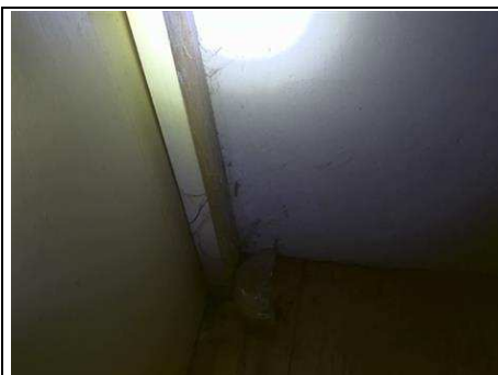
Photo n° PhTer018 Localisation : Etage 1 - PI 2 Ouvrage : Porte - bois et Peinture Parasite : Insectes à larves xylophages Indices : orifices obturés ou non, présence de vermoiture (présence sur tout l'élément concerné) Localisation sur croquis : 018
