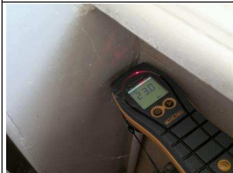
Photo n° PhTer012 Localisation : Rez de Chaussée - Bureau Ouvrage : Mur - plâtre et Tapisserie Informations complémentaires : Hygrométrie de surface égale à 23% au niveau de l'embrasure de fenêtre, Présence de moisissures sur les murs Localisation sur croquis : 012
