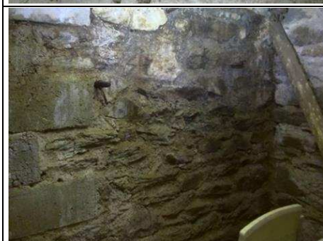
Photo n° PhTer001 Localisation : Sous-Sol - Cave 1 Ouvrage : Mur - pierres Informations complémentaires : Hygrométrie de surface mesurée supérieure à 25%, Présence de remontées capillaires, Présence de salpêtre Localisation sur croquis : 001
