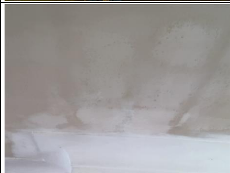
Photo n° PhTer025 Localisation : Rez de Chaussée - Séjour Ouvrage : Plafond - plâtre et Peinture Informations complémentaires : Présence de moisissures sur les murs Localisation sur croquis : 025
