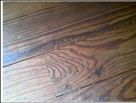
Photo n° PhTer014 Localisation : Rez de Chaussée - Chambre 1 Ouvrage : Sol - béton et Parquet Parasite : Insectes à larves xylophages Indices : orifices obturés ou non (présence sur tout l'élément concerné) Localisation sur croquis : 014
