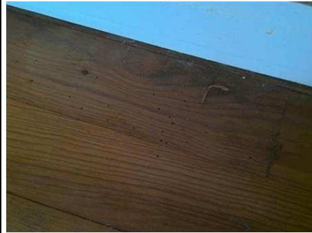
Photo n° PhTer016 Localisation : Etage 1 - Dgt Ouvrage : Sol - plancher inconnu et Parquet Parasite : Insectes à larves xylophages Indices : orifices obturés ou non (présence sur tout l'élément concerné) Localisation sur croquis : 016
