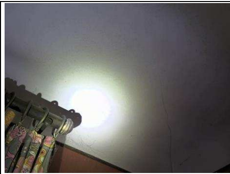
Photo n° PhTer013 Localisation : Rez de Chaussée - Chambre 1 Ouvrage : Aluminium laqué Informations complémentaires : Présence de moisissures sur les plafonds Localisation sur croquis : 013
