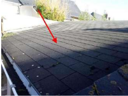
Photo n° PhA002 Localisation : Parties extérieures Ouvrage : 4. Eléments extérieurs - Toitures Partie d'ouvrage : Bardeaux bitumineux Description : Bardeaux bitumineux Localisation sur croquis : M002
