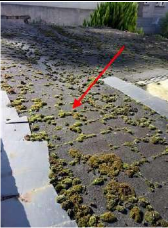
Photo n° PhA003 Localisation : Dépendance Ouvrage : 4. Eléments extérieurs - Toitures Partie d'ouvrage : Bardeaux bitumineux Description : Bardeaux bitumineux Localisation sur croquis : M003
