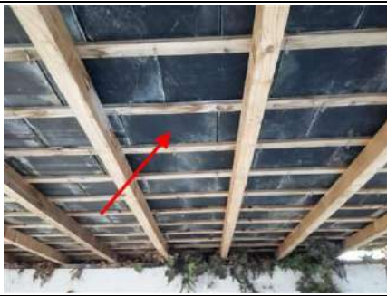
Photo n° PhA001 Localisation : Dépendance - Préau Ouvrage : 4. Eléments extérieurs - Toitures Partie d'ouvrage : Ardoises (fibres-ciment) Description : Ardoises (fibres-ciment) Localisation sur croquis : M001
