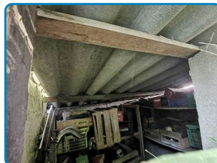
D.O. n° 3 sur Plafond Charpente en bois Plaques fibre-ciment
