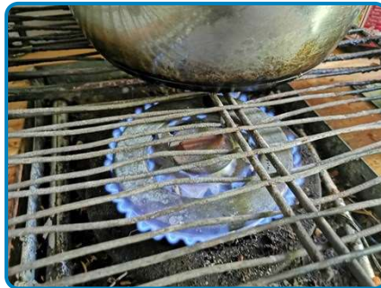
Appareil n°2 (Table de cuisson) sur installation n°1 (dans Maison individuelle Rez de chaussée Cuisine)
