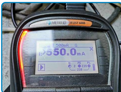
Anomalie B.2.3.1 h sur Install. n°1 (AGCP)
