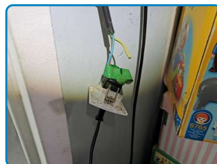
Anomalie B.3.3.6 a2 sur Install. n°1
