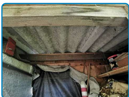
D.O. n° 4 sur Plafond Charpente en bois Plaques fibre-ciment
