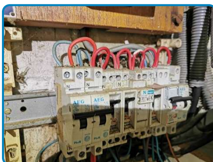
Install. n°1 App. n°1 (TRP n°1): Impossible de lire le courant de réglage sur l'AGCP Anomalie B.3.3.6.1 sur Install. n°1
