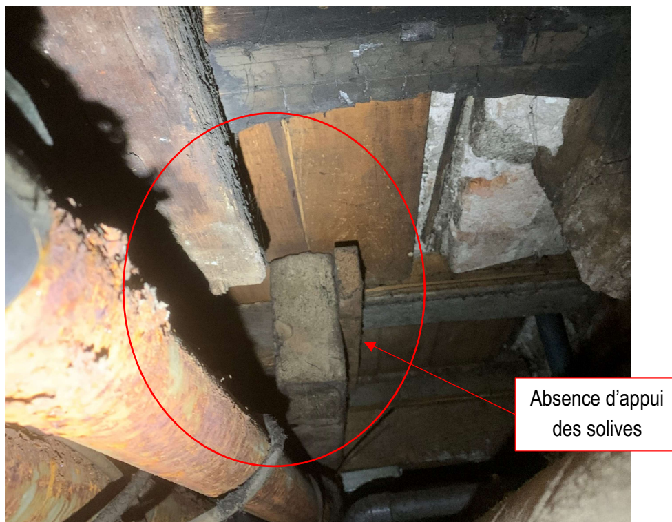
Photographie du désordre en zone 2 – Plancher haut RDC
