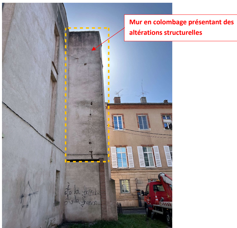
Photographie du désordre en zone 4 et 5
