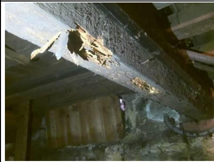
Photo n° PhTer001 Localisation : Sous-Sol - Cave Ouvrage : Plafond - Solivage bois Parasite : Présence d'indices d'infestation de termites, Termites souterrains Indices : altérations dans le bois
