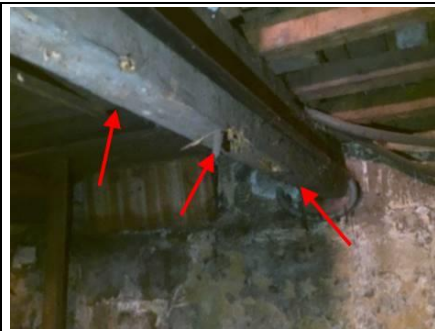
Photo n° PhTer001 Localisation : Sous-Sol - Cave Ouvrage : Plafond - Solivage bois Parasite : Présence d'indices d'infestation de termites, Termites souterrains Indices : altérations dans le bois
