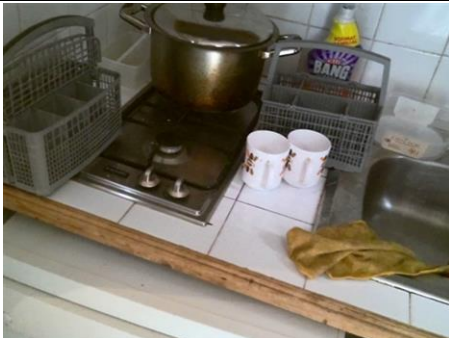
Photo n° PhGaz002 Localisation : Arriere cuisine Cuisinière HUDSON (Type : Non raccordé)
