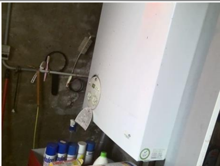
Photo n° PhGaz001 Localisation : Cellier Chaudière CHAFFOTEUX & MAURY (Type : Raccordé)
