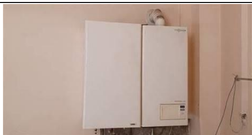
Photo n° PhGaz001 Localisation : Extérieur (6) – local chaudière Chaudière Viessmann (Type : Etanche)
