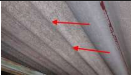
Photo n° PhA002 Localisation : Extérieur - abris de piscine Ouvrage : Substrats et revêtements Partie d'ouvrage : Parties accessibles Description : Plafond - solive + tole fibre ciment et fibociment Localisation sur croquis : oui
