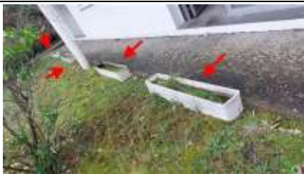
Photo n° PhA003 Localisation : Extérieur - extérieur Ouvrage : Substrats et revêtements Partie d'ouvrage : Parties accessibles Description : jardinière de fleur - fibociment Localisation sur croquis : oui
