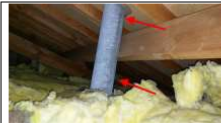
Photo n° PhA001 Localisation : Étage 1 - combles Ouvrage : Substrats et revêtements Partie d'ouvrage : Parties accessibles Description : Conduit(s) d'évacuation - tube fibociment Localisation sur croquis : oui
