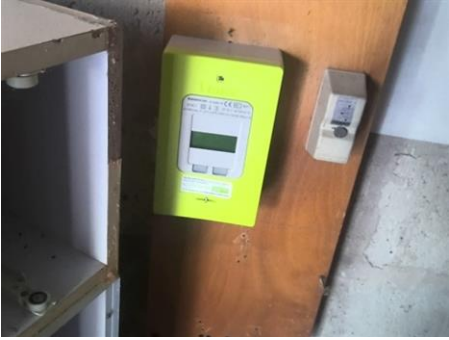
Photo du Compteur électrique
