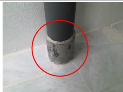
Photo n° PhA001 Localisation : Loggia Ouvrage : Conduits de fluides (air, eau, autres fluides) Partie d'ouvrage : Conduits Description : Conduits
